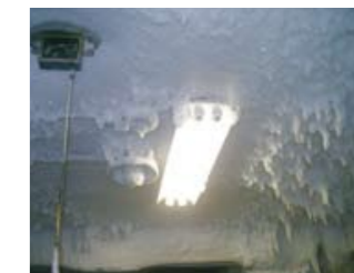
倉庫(冷凍)内照明
